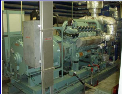
消化ガスエンジン
