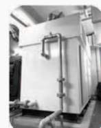
自家発電設備
